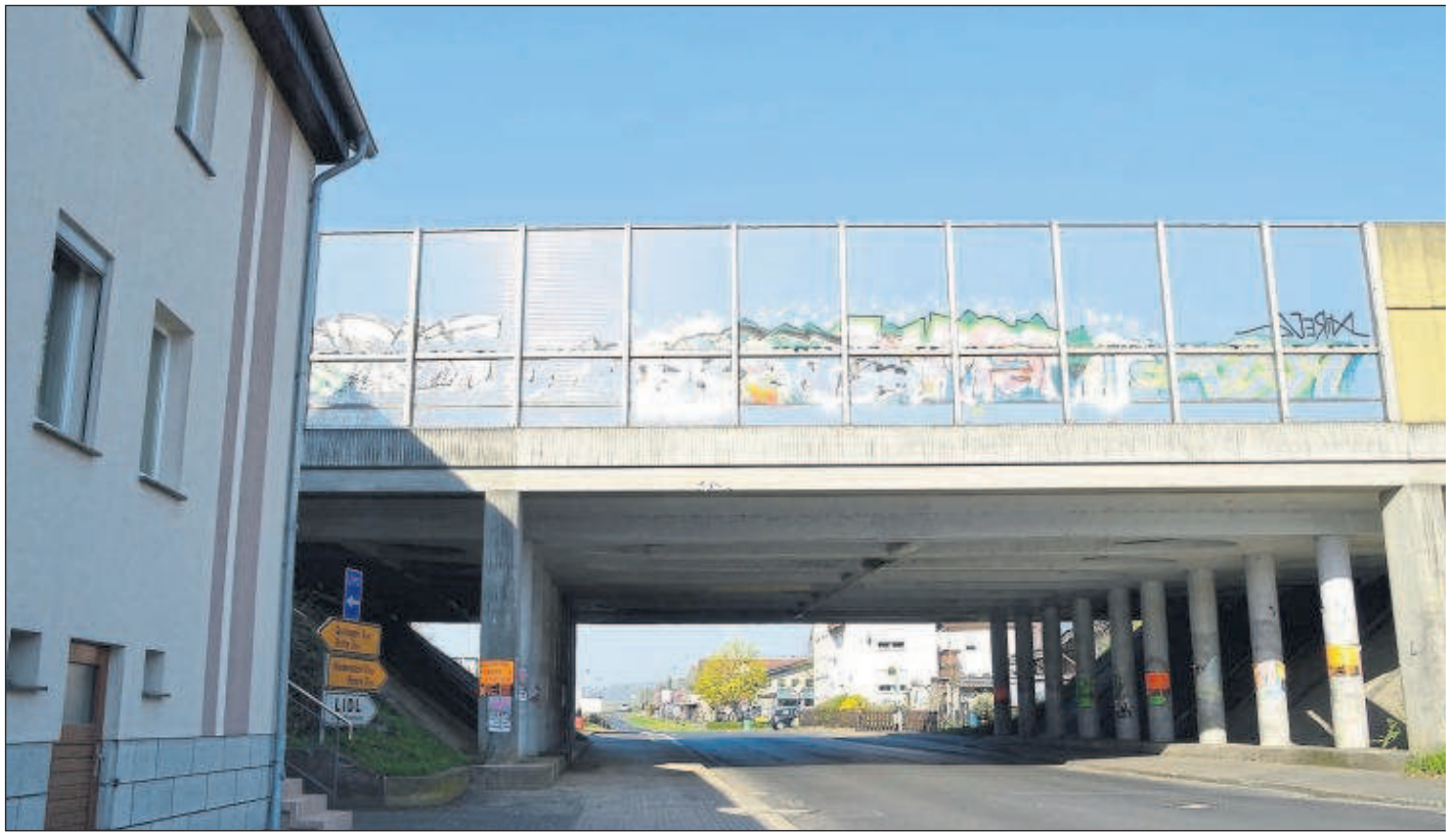
Keine 20 Meter von der maroden Brücke in Holzhausen/Hahn entfernt: Familie Degenhardt wohnt in dem Haus links. Seit Monaten ist bekannt, dass die Brücke repariert werden muss. Die Anwohner leiden und fühlen sich nicht ernstgenommen. Foto: ul
